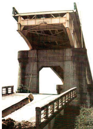
昭和53年の宮城県沖地震による落橋
