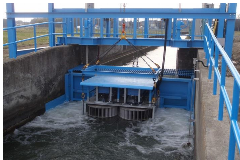
設置例：内川小水力発電所（大崎市）
