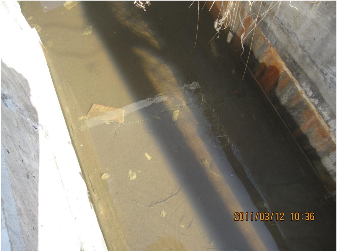
⑤-3 水路のクラック
