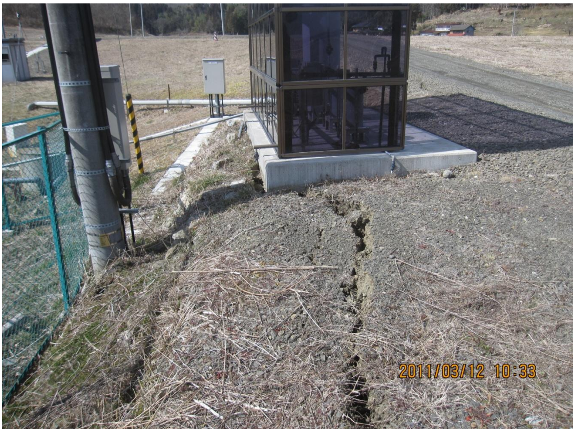
⑥-3 電柱脇のネットフェンス 10m 基礎ズレ (法肩崩れ)
