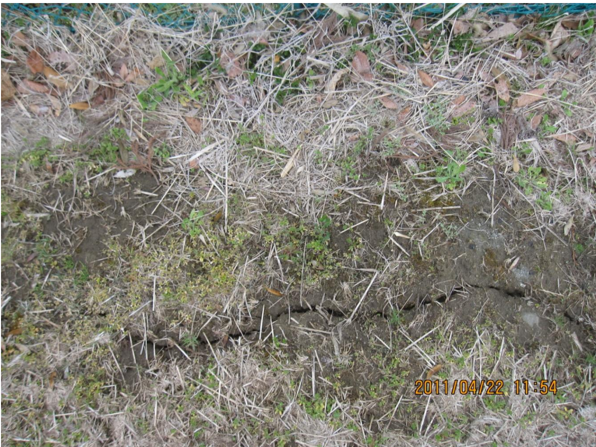
②-2 北側フェンスに沿って約 120m 亀裂
