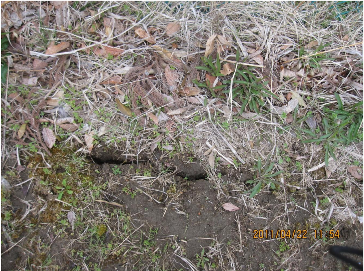
②-1 北側フェンスに沿って約 120m 亀裂
