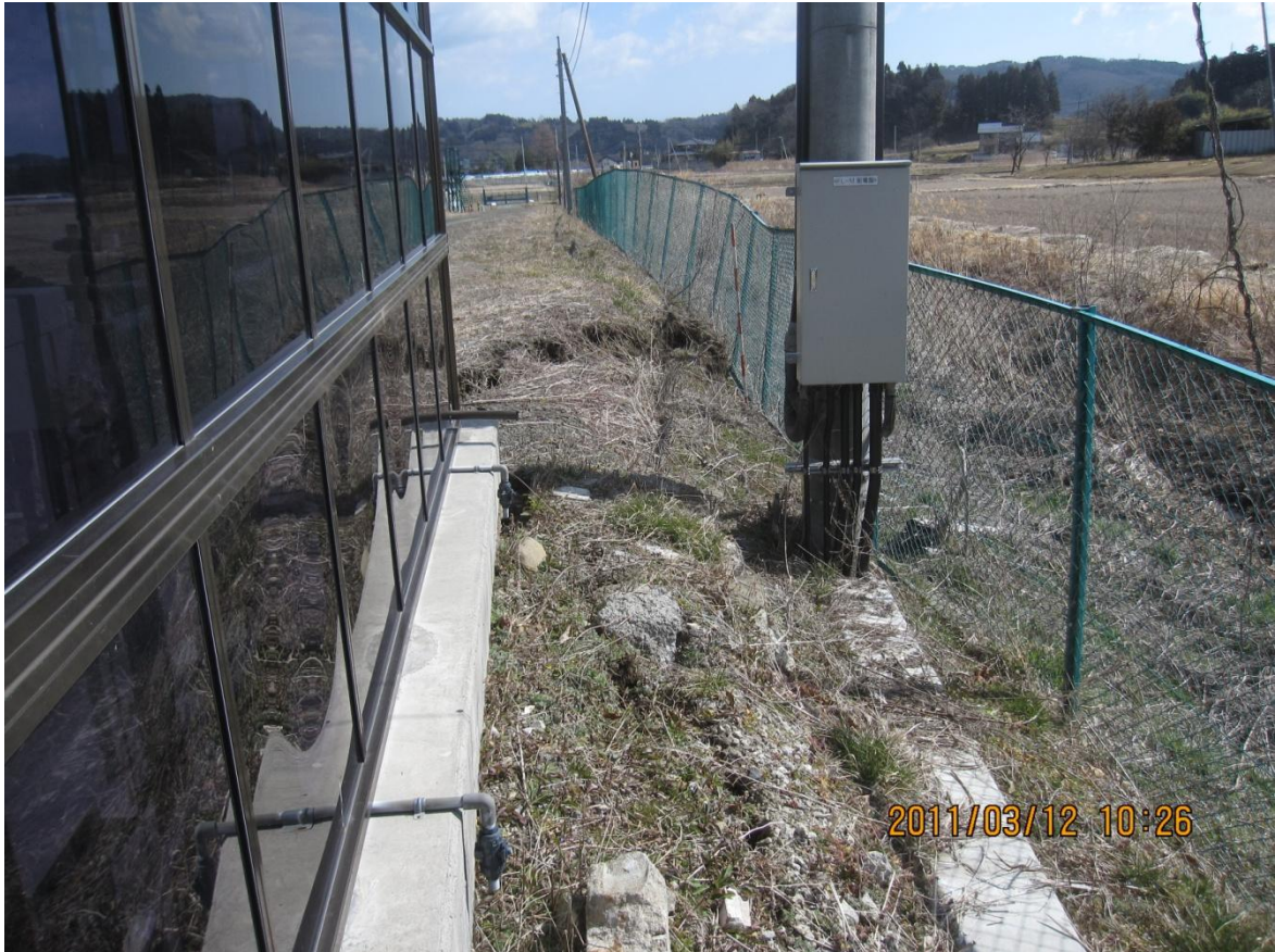
⑥-2 電柱脇のネットフェンス 10m 基礎ズレ (法肩崩れ)
