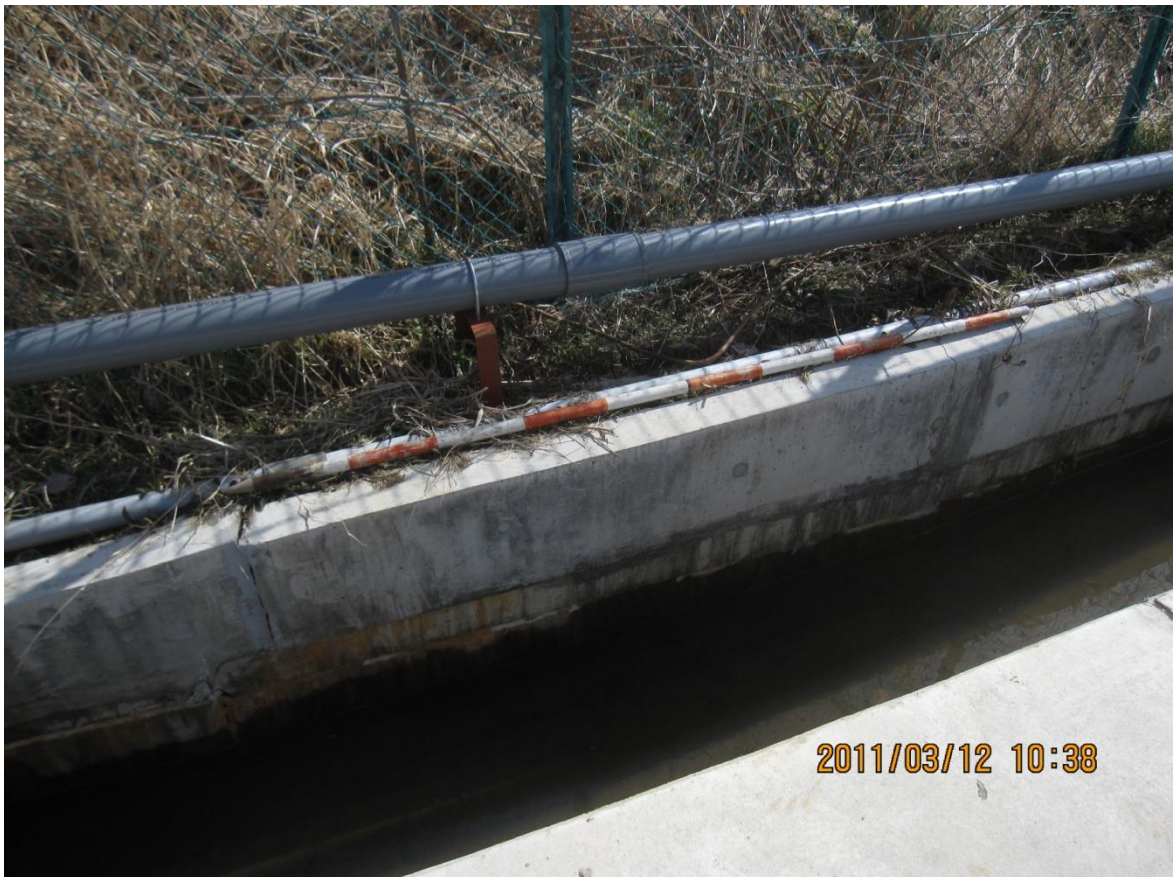
⑤-4 嵩上げコンクリートぐらつき
