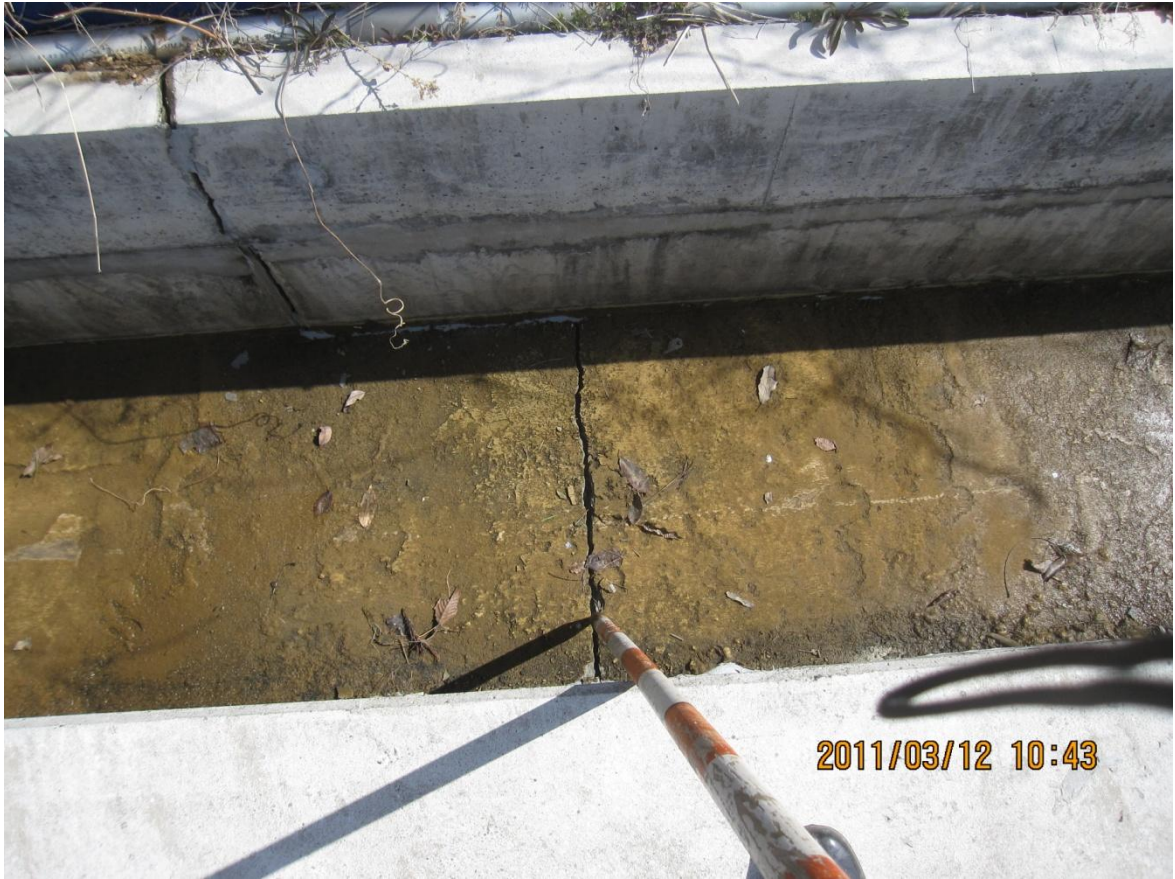
⑤-7 水路底クラック
