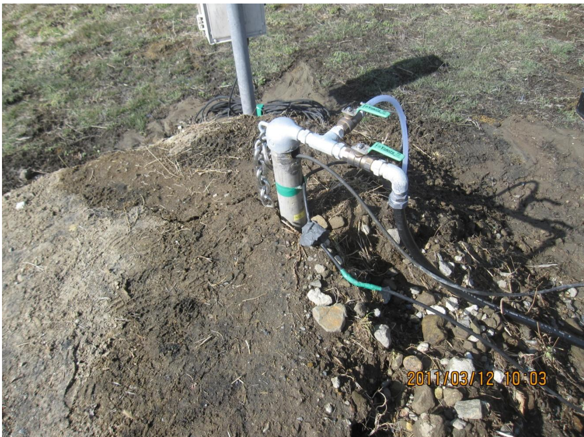
③-2 No. 3 浸透水噴出跡
