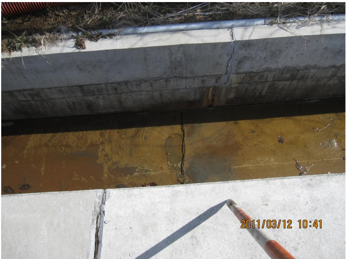
⑤-6 水路底クラック
