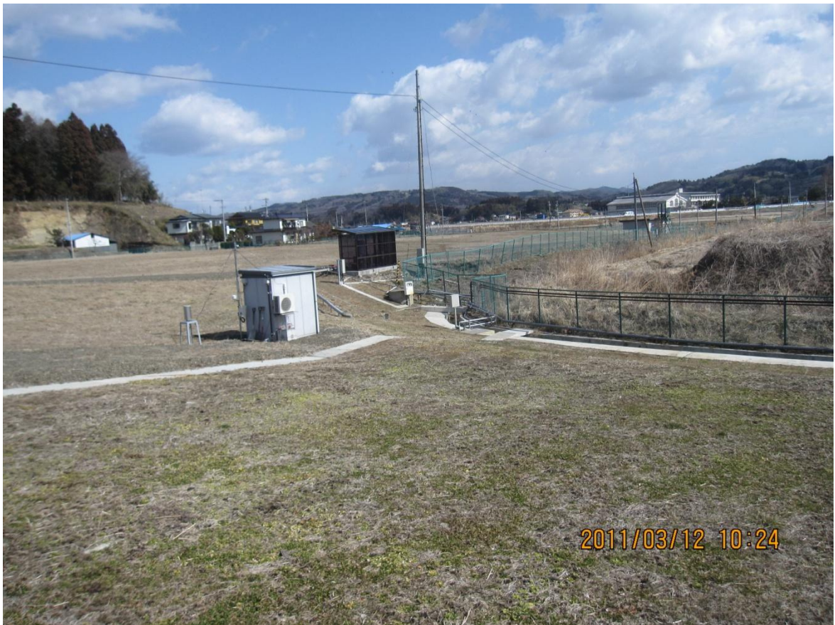
⑥-1 電柱脇のネットフェンス 10m 基礎ズレ (法肩崩れ)
