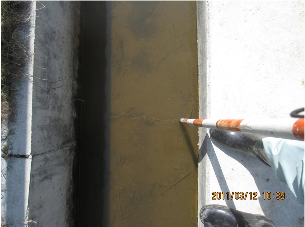
⑤-5 水路底クラック
