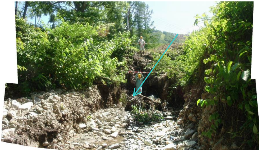
支溪上流の荒廃状況 (H19.6大雨後)
