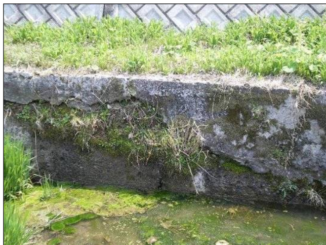
堤体裏側の亀裂
