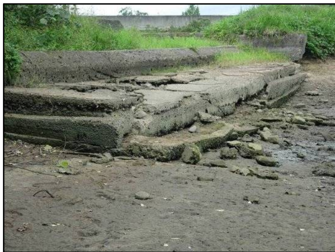
洪水吐劣化状況
