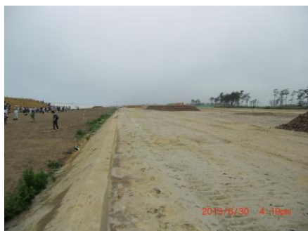
岩沼市相ノ釜地区での生育基盤造成(盛り土)工事, 左側に国交省で設置した海岸防潮堤を望む
