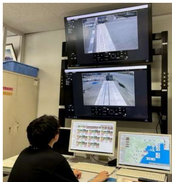
◎水門・陸閘自動閉鎖システムの遠隔操作状況
