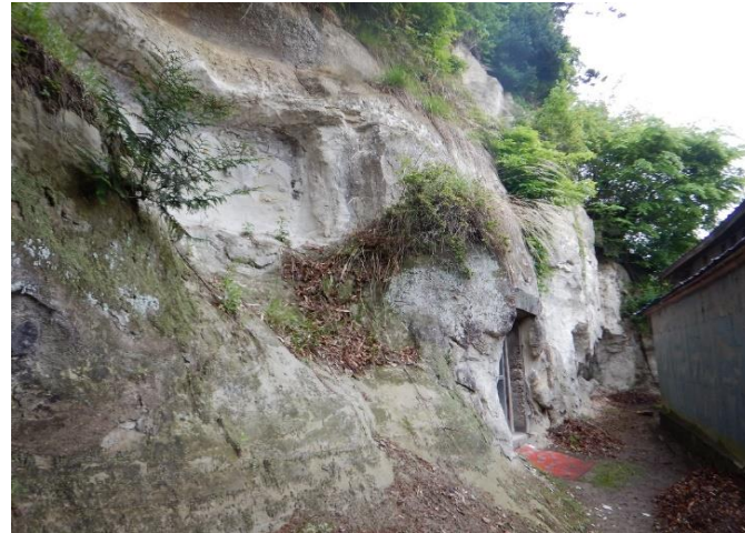
大郷町下り松(急傾斜地崩壊)
