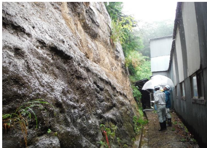
塩釜市松陽台(急傾斜地崩壊)
