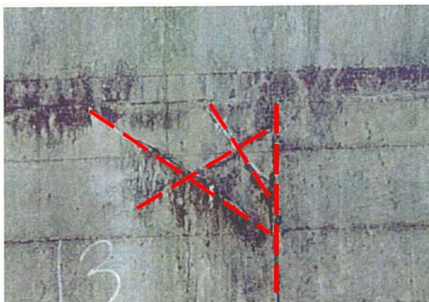
写真- 6.1。1 ブロック化したひび割れの例
