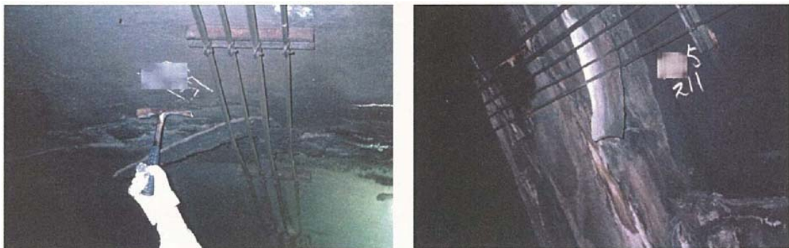
写真- 4.3。9 補修モルタルが劣化してはく離している例
