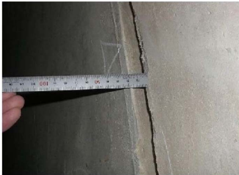
写真- 4.3。8 段差の例
