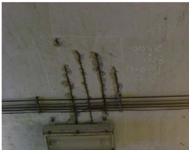
写真- 6.1. 2 鋼材腐食の例
