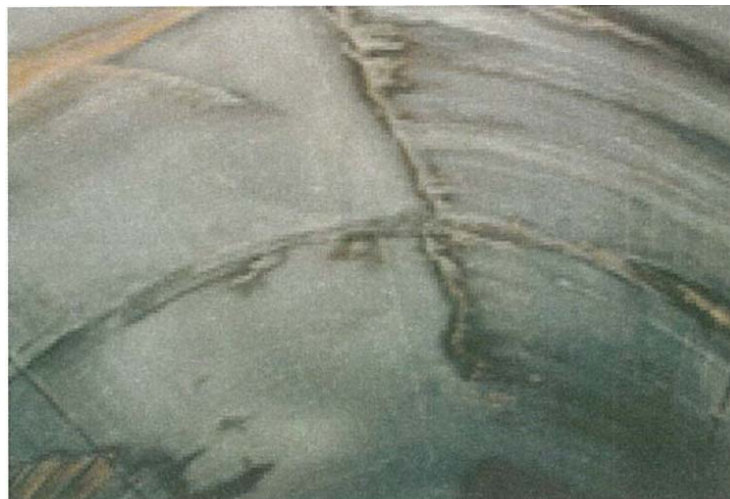
写真- 4.3。3 覆工の天端付近に発生した縦断方向のひび割れの例
