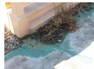
排水柵土砂堆積の状況
