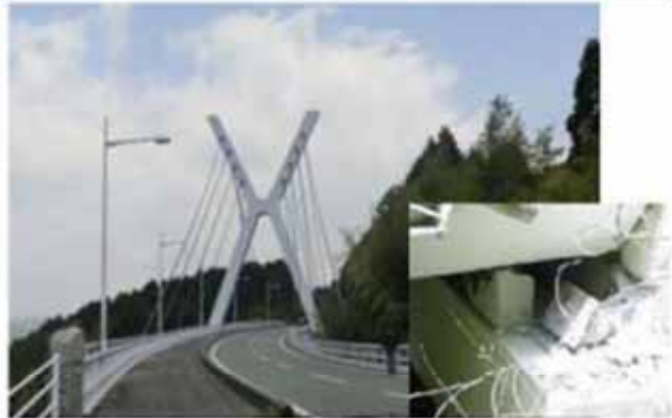
写真-6 支承部の損傷 (桑鶴大橋)
