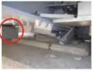
写真-6 支承の破損の状況
