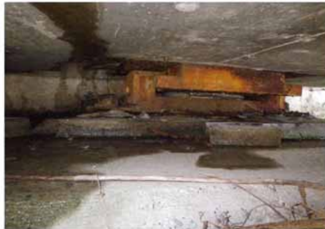
支承腐食 A1橋台
