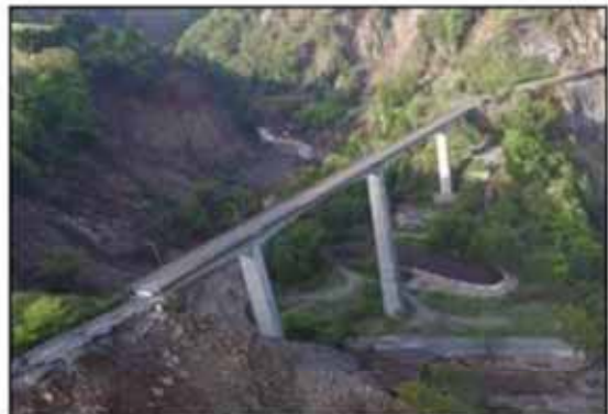
写真-8 橋台の損傷 (阿蘇長陽大橋)
