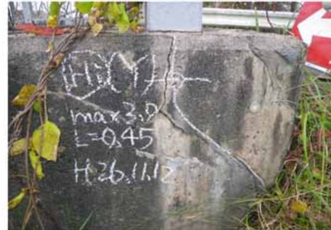
ひび割れ、鉄筋露出 A2橋台
