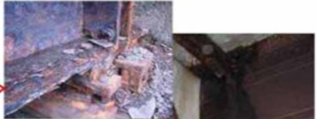
死角となっている箇所では損傷発見
