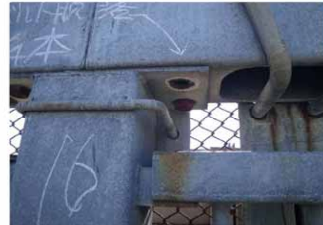
鋼製高欄金具脱落 (A1～P1)東京側
