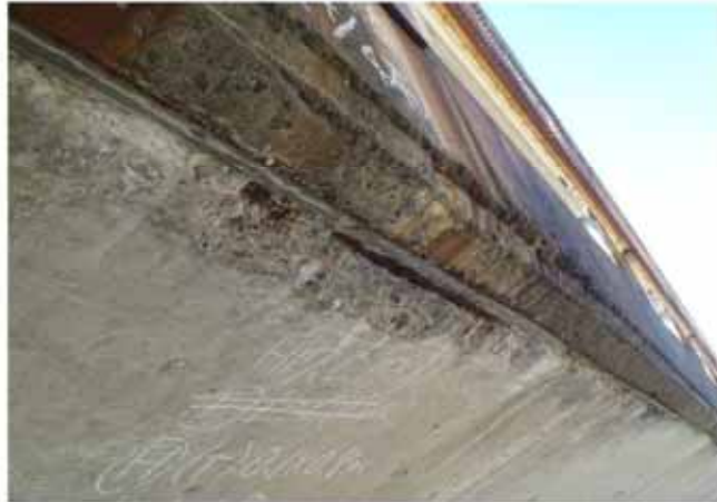
床版張出 はく離、鉄筋露出 P1～P2間
