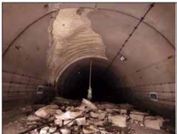
写真-7 覆エコンクリートの崩落 (俵山トンネル)
