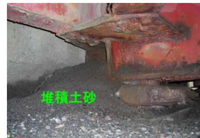
土砂堆積状況
