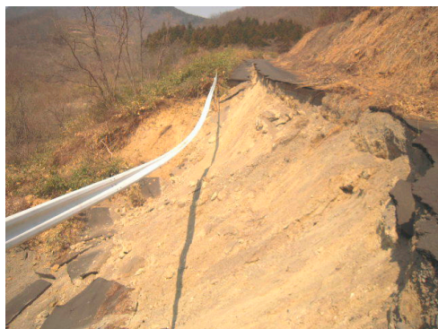
写真-1 林道の被害(大和町)
