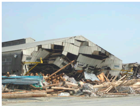
写真-4 合板工場の被害(石巻市)
