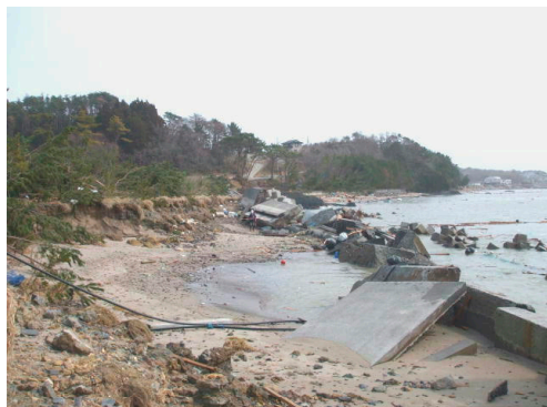
写真-3 海岸防潮堤の被害(南三陸町)
