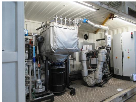
小型木質バイオマス熱電併給施設
