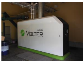
小型バイオマス発電施設
