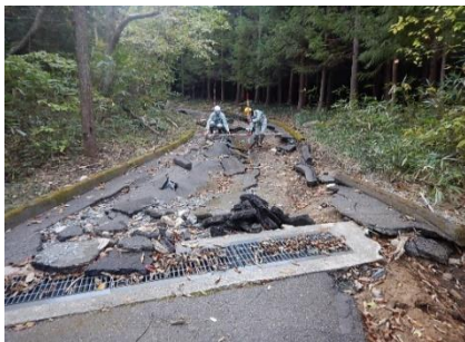
令和元年東日本台風による路面洗掘
