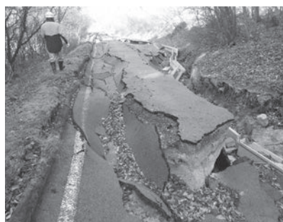
林道「大谷地線」被災状況
