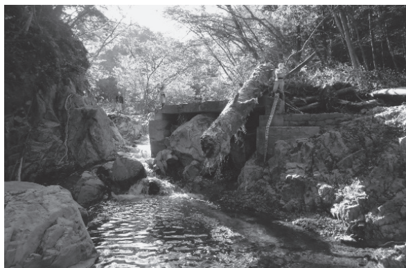
橋梁が転石により閉塞したことに伴う被害 (丸森町河内線)
