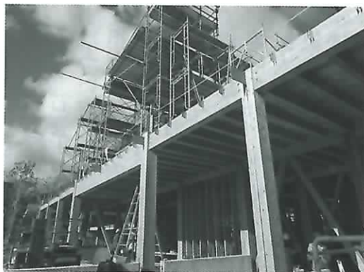
火災直後、足場だけが残ったA棟 現在、再建が進められています
