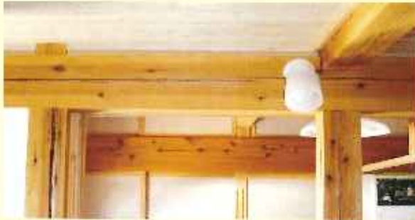
▲梁に生じた「割れ」
