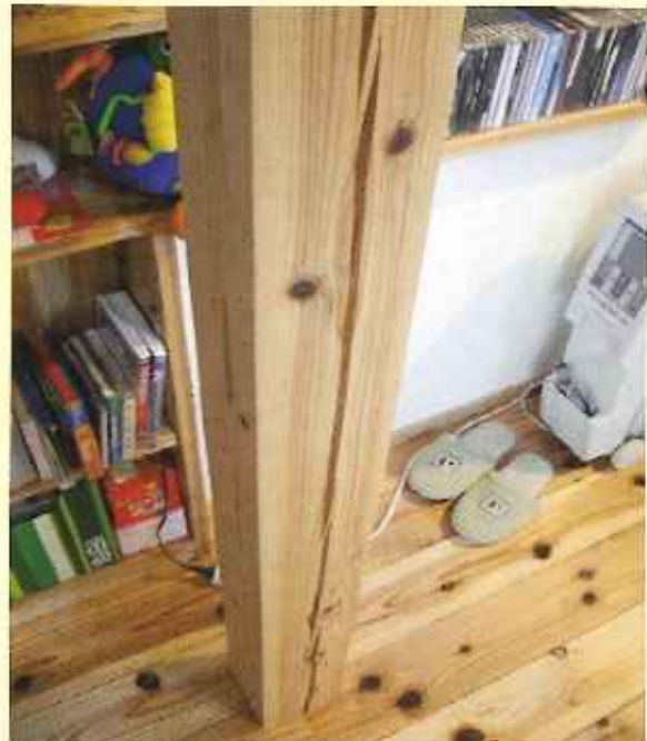
▲柱に生じた「割れ」
