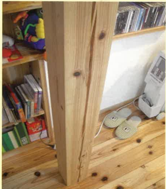
▲柱に生じた「割れ」
