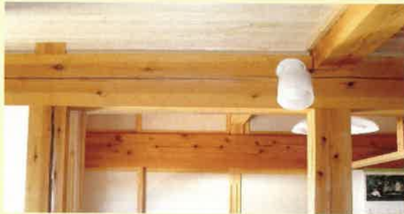
▲梁に生じた「割れ」
