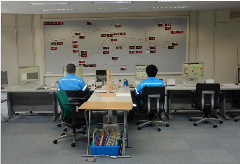
ちゅうおうかんしつ 中央監視室の様子
