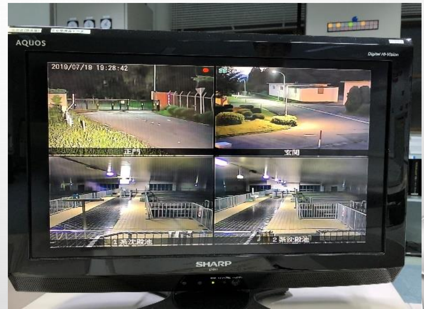
ちゅうおうかんしつ 中央監視室のモニター
