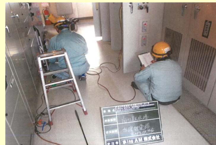
受変電設備点検
