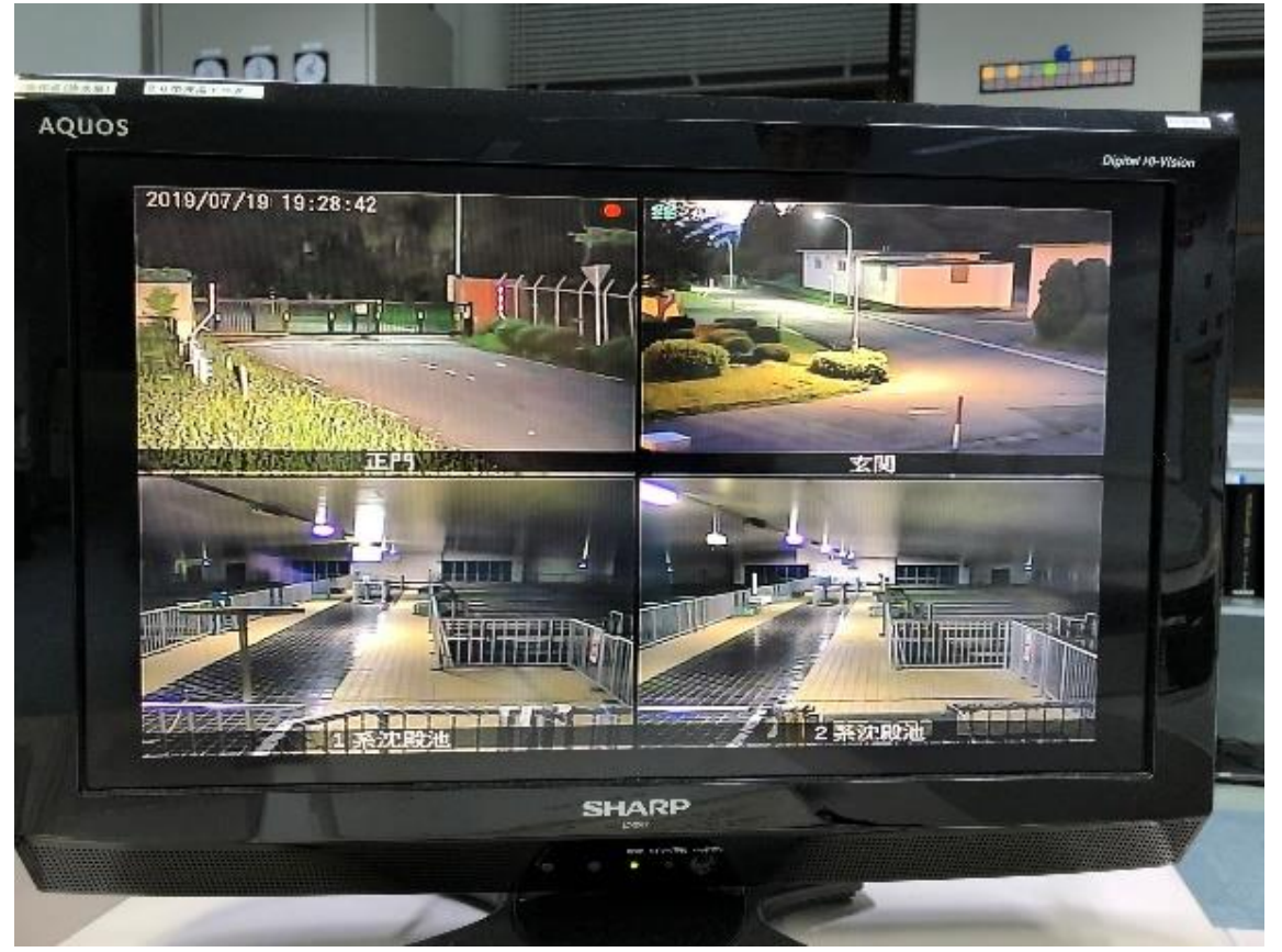
モニターによる監視状況
