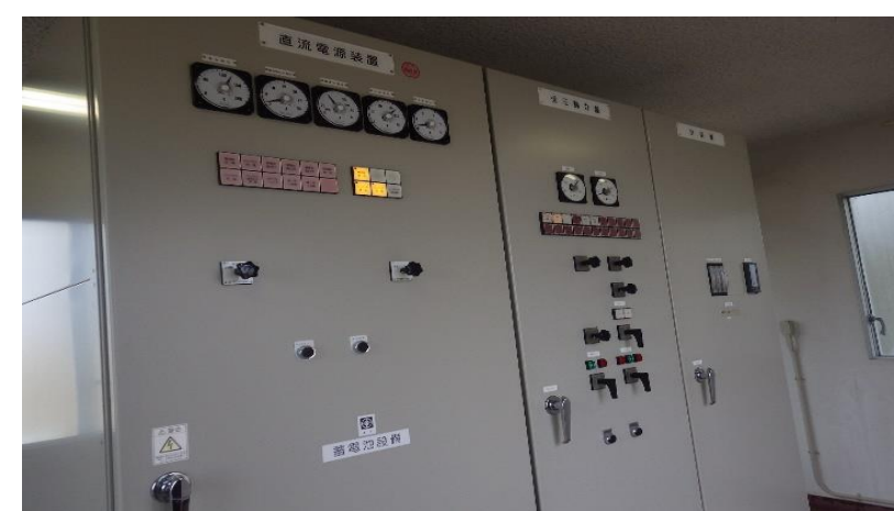
テレメータ室内の計器状況
