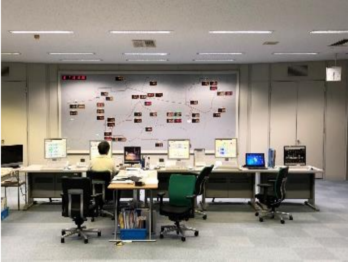
中央監視室の監視状況
