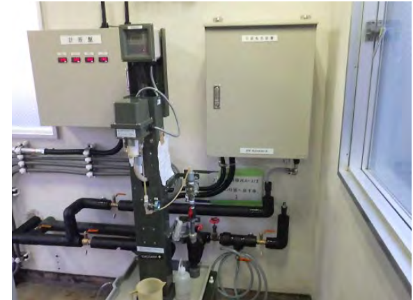
末端受水水質監視装置点検状況
