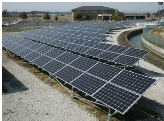
【大崎地区】大崎土地改良区大崎太陽光発電所
