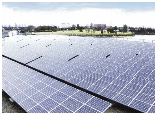
【仙台東部地区】大沼太陽光発電所
