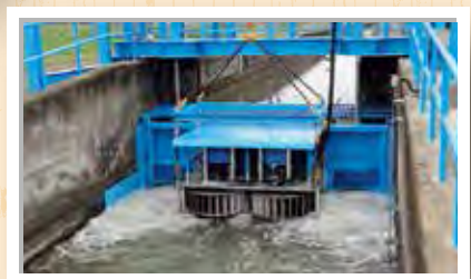
内川小水力発電所(大崎市)
