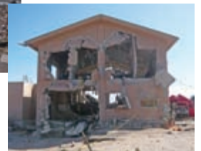
津波による排水機場の被災(山元町)
