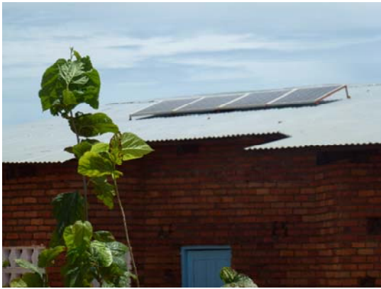
写真 67：電源のソーラーパネル
