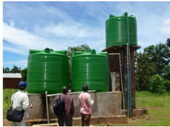
写真 68：貯水タンク（灌漑1基、上水道2基）
