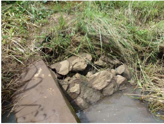
写真 75：河川の増水による破損
