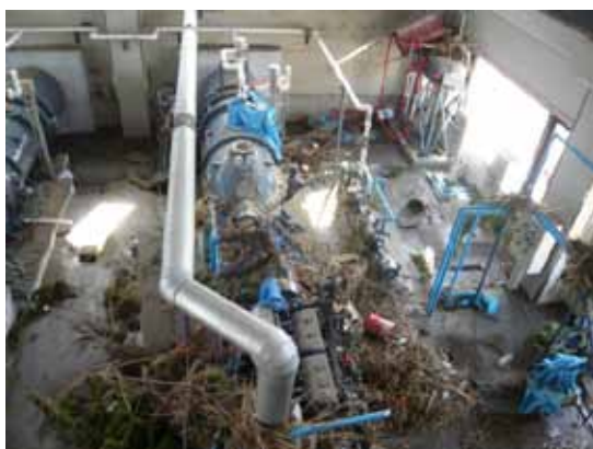
▲写真 被災直後の排水機場（H23年3月）
