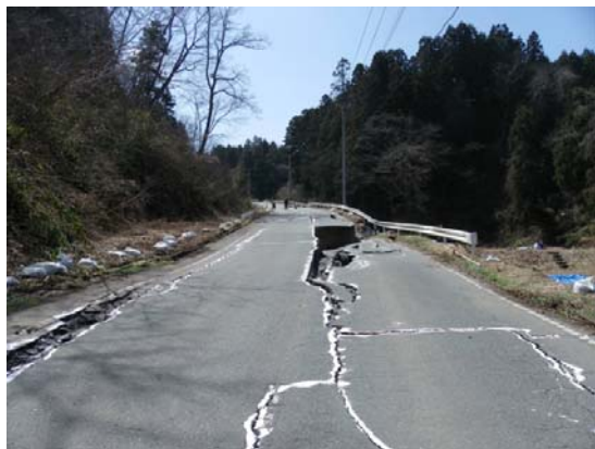
▲写真 農道の被災状況
