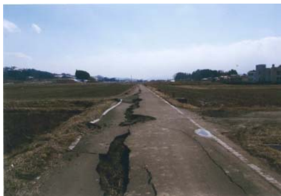
▲写真 農道の被災状況
