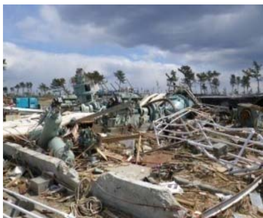
▲写真 二郷堀排水機場(仙台市)被災状況
