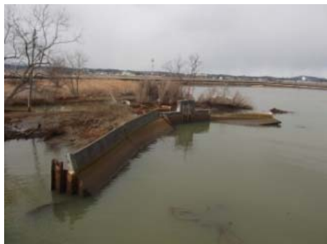
▲写真 大曲排水機場（東松島市）被災状況
