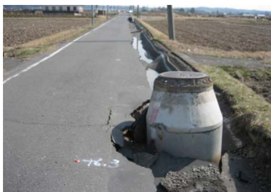
▲写真 農業集落排水管路施設の被災状況
