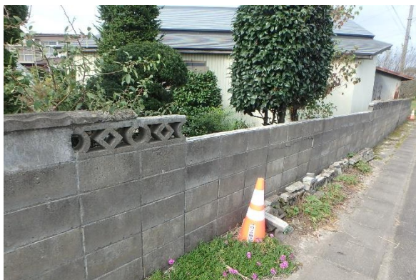
上写真)危険と判定されたブロック塀等の例
