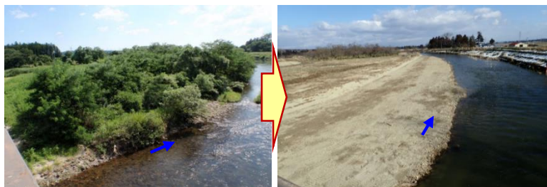
堆積土砂及び支障木の撤去状況(平成30年度施工) ＜一級河川鳴瀬川水系田川＞
