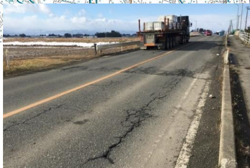
国道347号 大崎市古川飯川地区の路面状況
