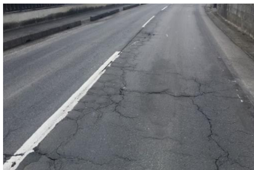
一般県道鳴瀬南郷線 美里町木間塚地区の路面状況
