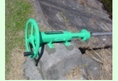
ゲート、バルブの更新
