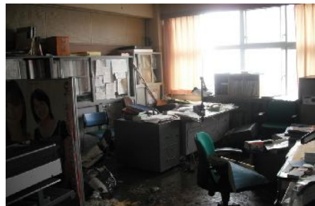
(物品類が散乱している事務室)
