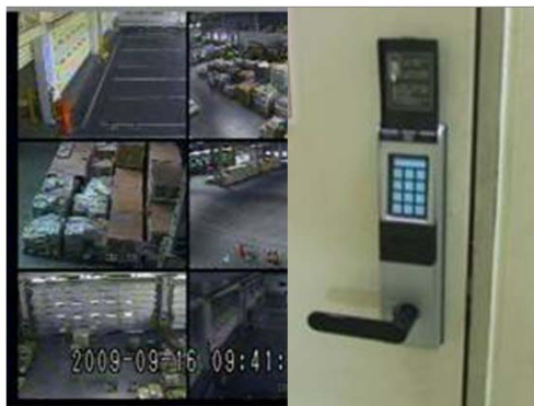
監視モニター・各フロアセキュリティー
