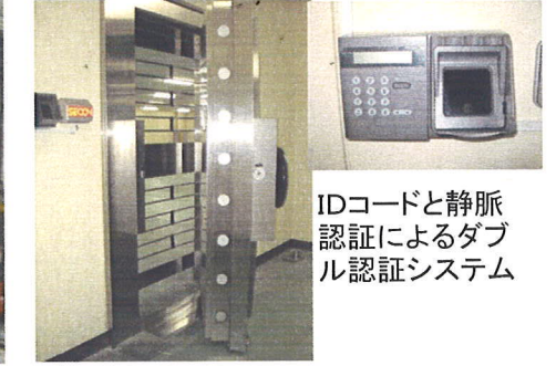
セキュリティ倉庫
