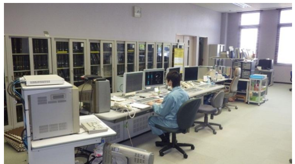
石巻浄化センター 中央監視室
