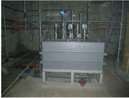
▲流入水質測定装置設置状況
