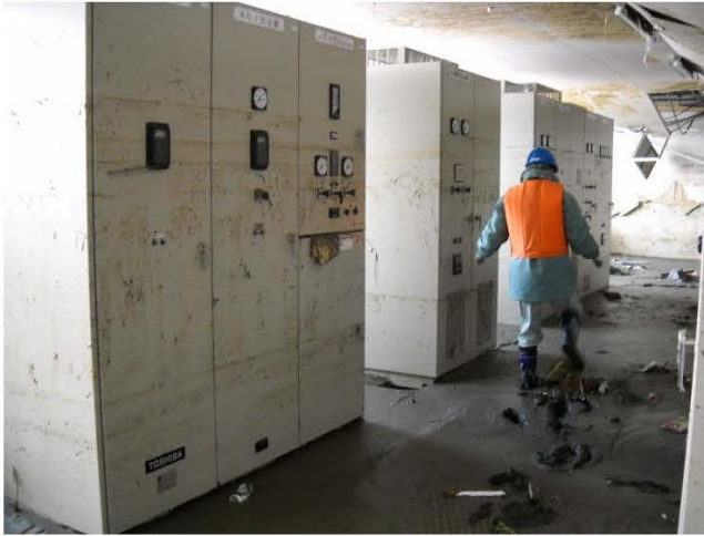
⑪脱水機棟 1階電気室の被災状況
