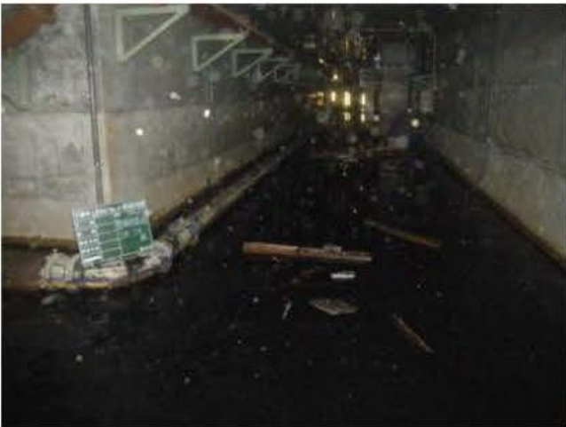
地下管廊内部へ流入した海水と瓦礫
