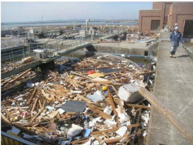
①最終沈殿池に流入した瓦礫
