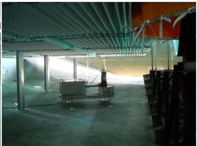
⑩微細気泡発生装置の槽内設置状況
