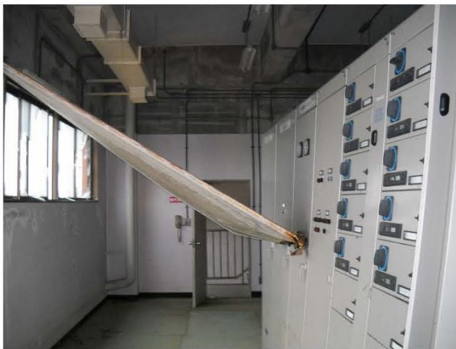
⑧砂ろ過棟電気室の被災状況
