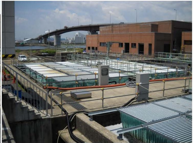
⑩簡易生物処理施設の設置状況 (H24.4月・5月)
