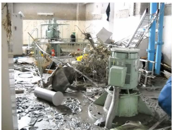
⑤汚水ポンプ設備の被災状況
