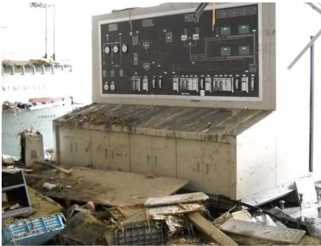
⑫脱水機棟 1階操作室の被災状況
