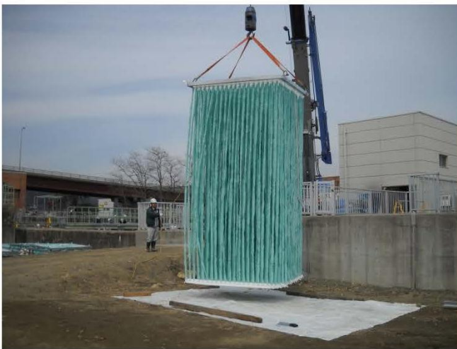
⑩生物処理用接触材の状況
