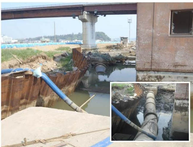
⑨放流管の被災状況
