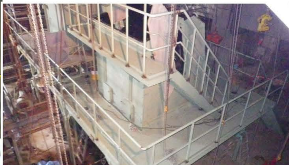
④除塵設備の設置状況
