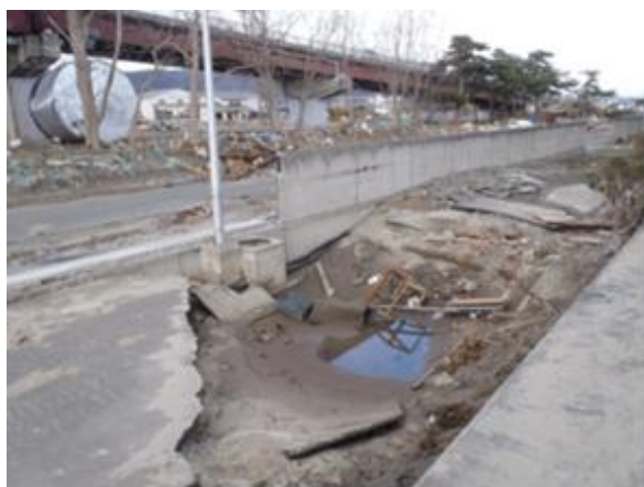
石巻東部浄化センター内舗装破損状況
