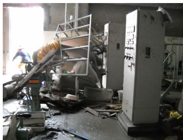
汚水ポンプ現場盤被災状況
