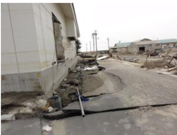
石巻第6ポンプ場建屋被災状況
