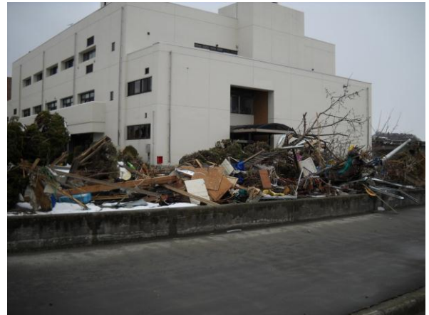
管理棟被災状況
