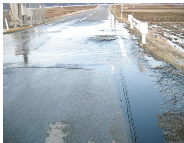
河北桃生第1ポンプ場開放点溢水状況
