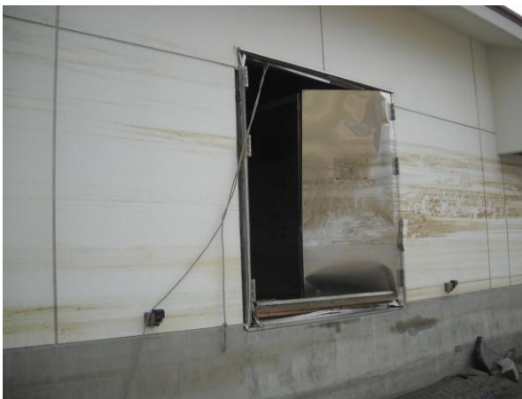
石巻第6ポンプ場電気室扉被災状況
