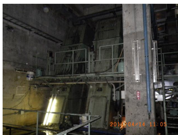
石巻第6ポンプ場建屋内部被災状況
