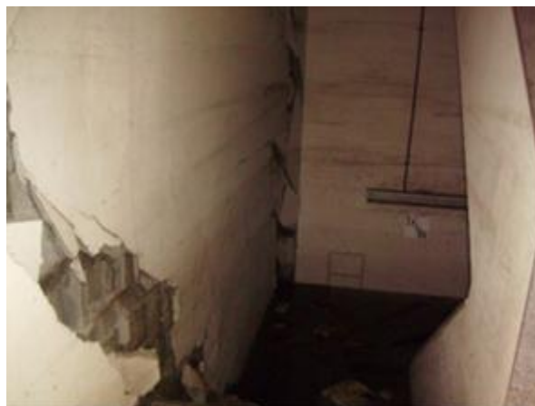
管理棟階段破損状況
