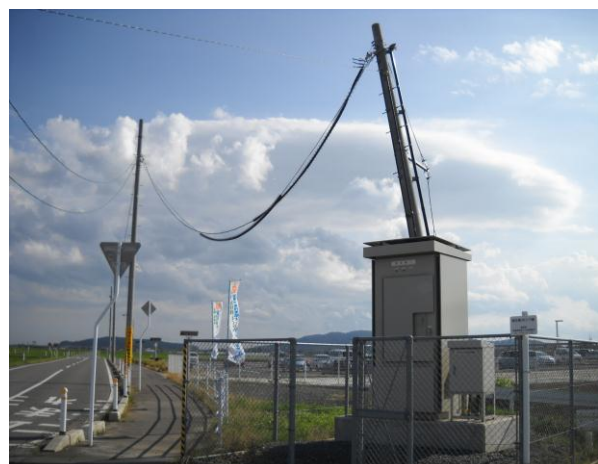
桃生第1ポンプ場電柱傾き状況
