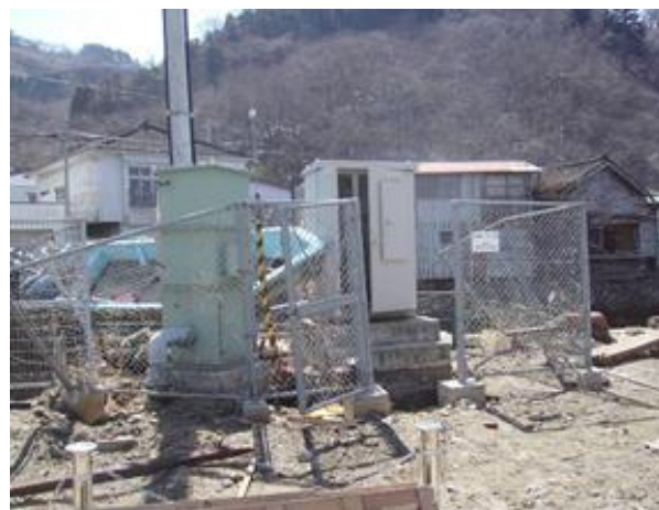
石巻第2ポンプ場浸水被害状況
