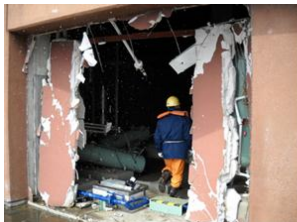
水処理棟南側破損状況
