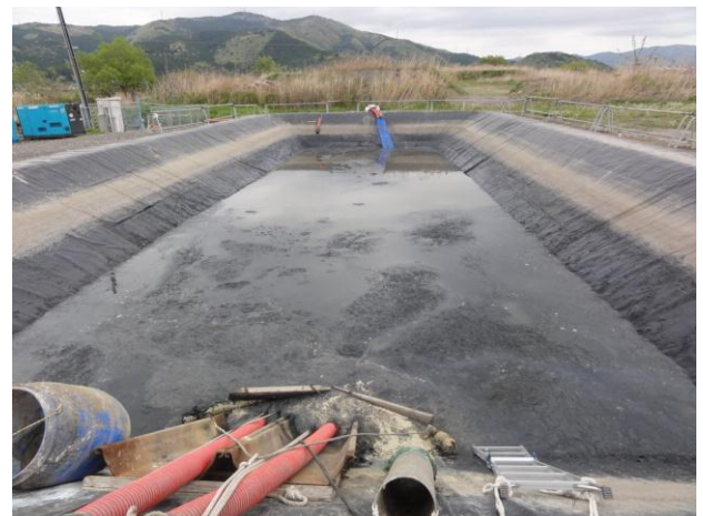
石巻第2ポンプ場仮沈殿池稼働状況
