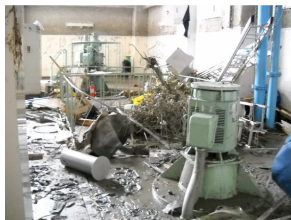
汚水ポンプ被災状況
