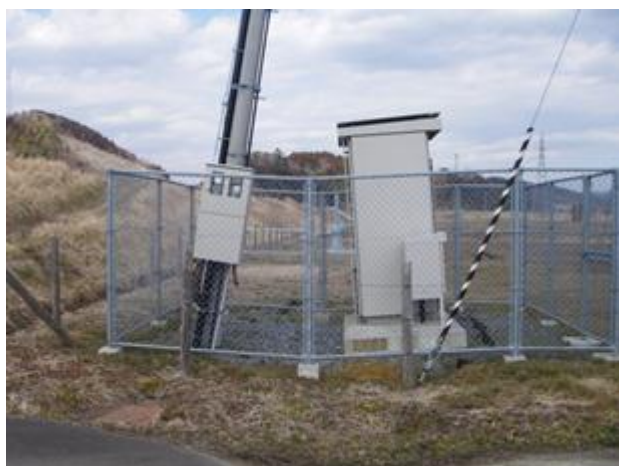
河北第3ポンプ場被害状況
