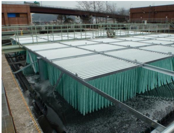
簡易生物処理設備設置状況
