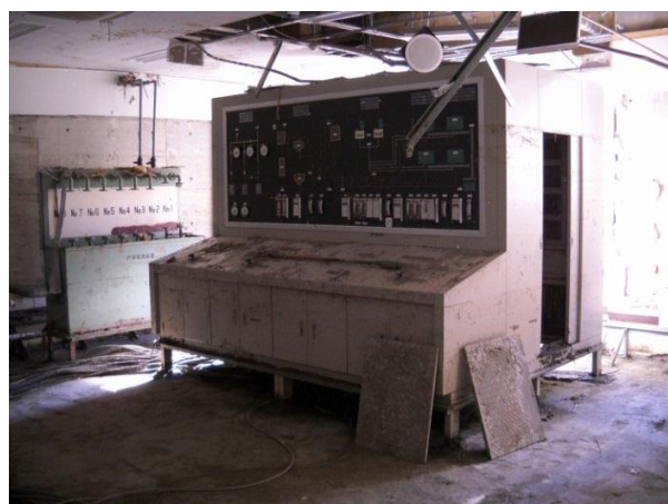
汚泥棟監視制御装置被災状況
