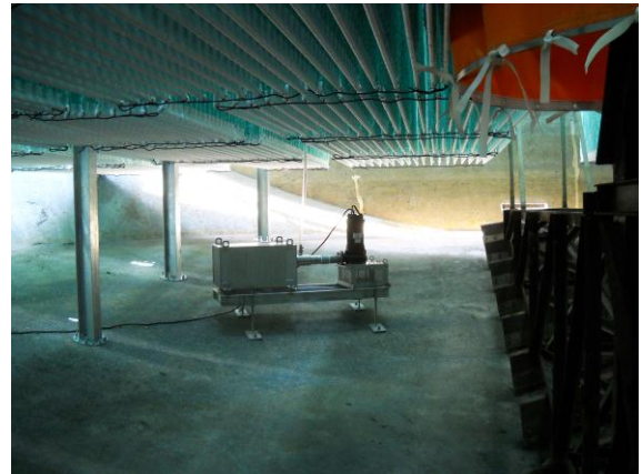
槽内曝気装置設置状況
