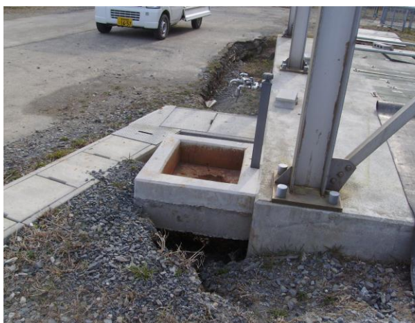
女川第1ポンプ場陥没状況
