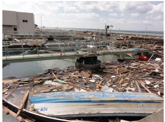
最終沈殿池被災状況
