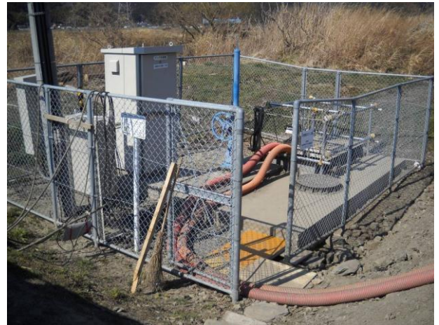
石巻第2ポンプ場仮設ポンプ稼働
