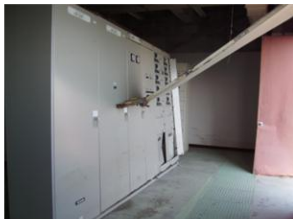
汚泥棟電気室破損状況
