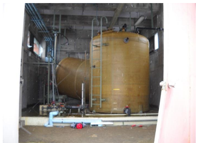
次亜塩素酸ナトリウム貯槽倒壊状況
