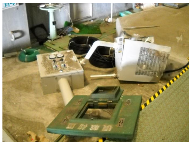
現場盤倒壊状況
