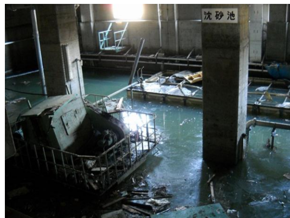
沈砂池水没状況
