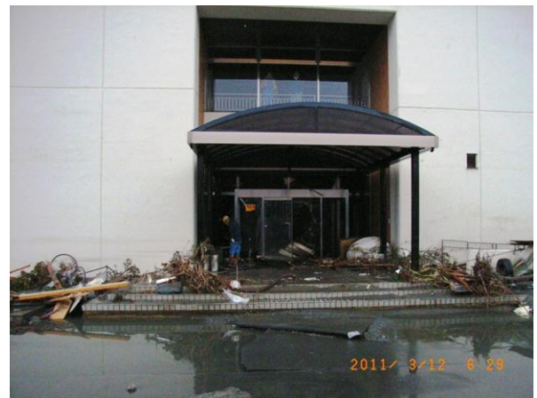
正面玄関被災状況
