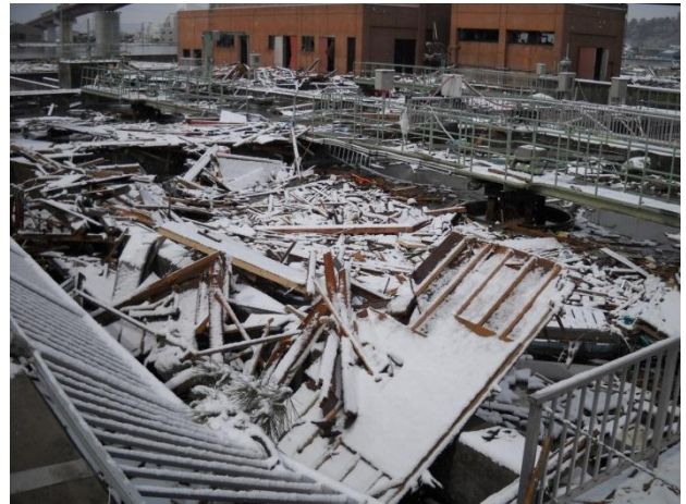
最終沈殿池被災状況
