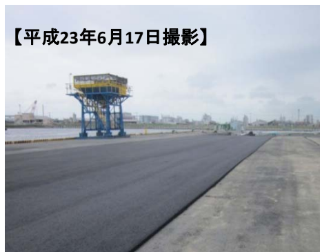
応急復旧状況 雲雀野中央ふ頭2号(-13m)
