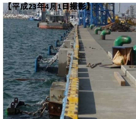
防舷材水没状況4.1 15:00 (14:36 満潮) 雲雀野中央ふ頭2号(-13m)
