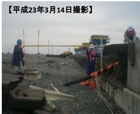
エプロン背後沈下状況 雲雀野中央ふ頭2号(-13m)
