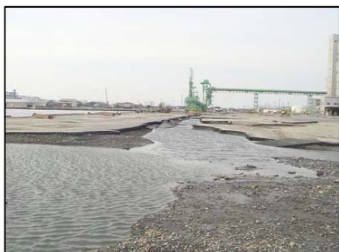
日和6号埠頭の被災状況
