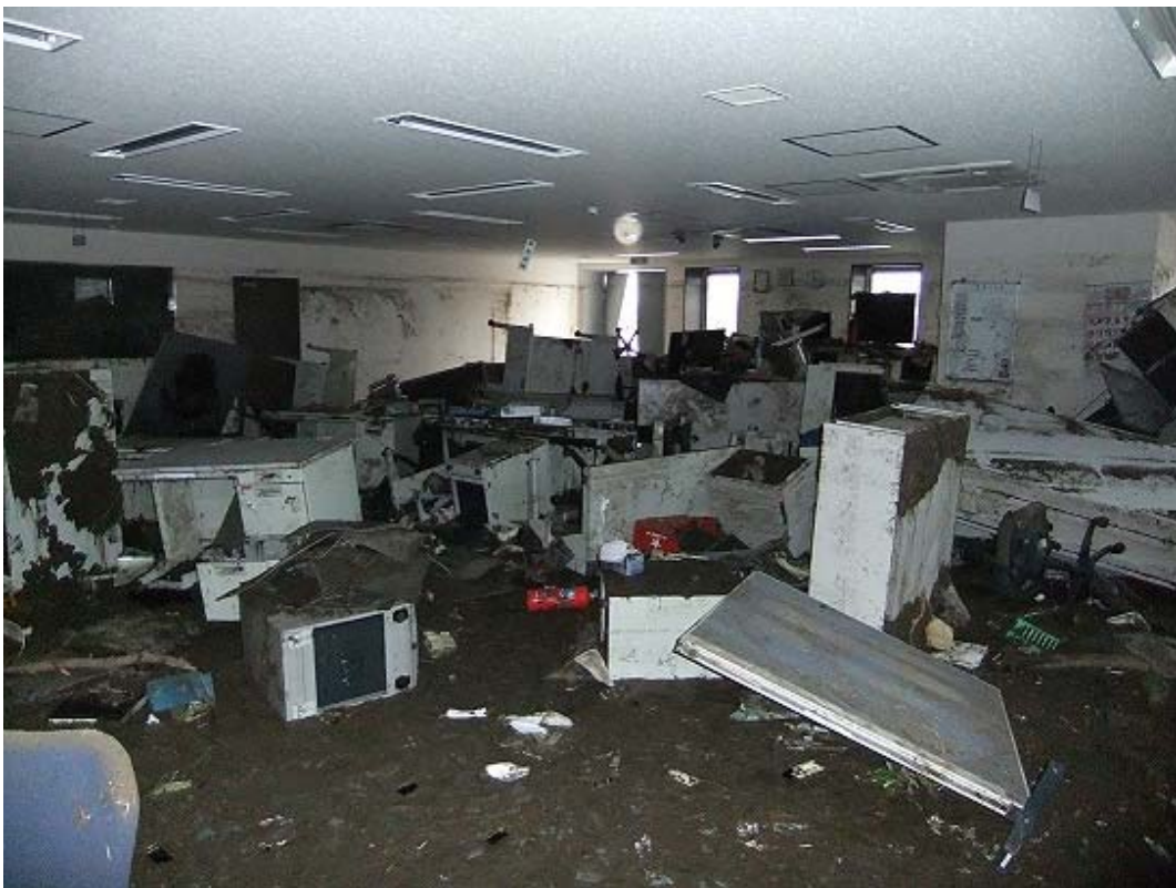
仙台空港アクセス鉄道 仙台空港駅1階運輸管理所内の状況
