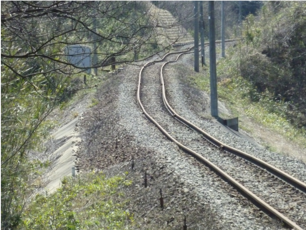
阿武隈急行鉄道 北丸森駅付近の軌道狂いの状況
