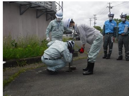
<実技（排泥弁操作）>
