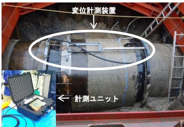
変位計測装置と計測ユニット
