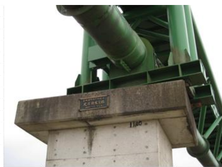
北屋敷水管橋の支承部損傷によるずれ
