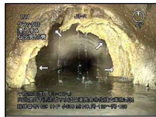
阿武隈川幹線管路施設
