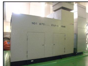
自家発電設備
