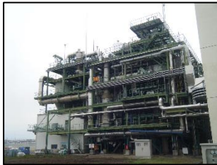
汚泥焼却施設
