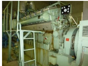
自家発電設備
