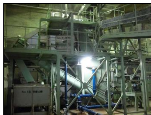
沈砂し渣混合洗浄装置
