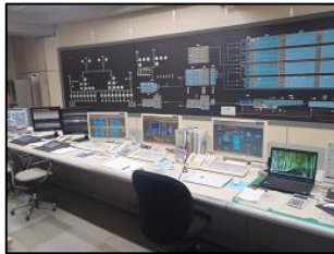
監視制御設備
