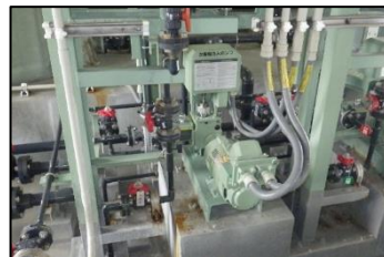
次亜注入ポンプ
