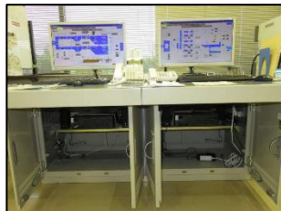
中央監視設備
