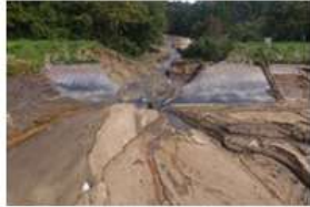
豪雨による堤体の決壊
