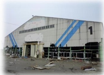
被災した木材加工施設
