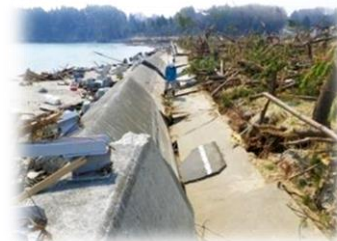
被災した防潮堤と海岸林
