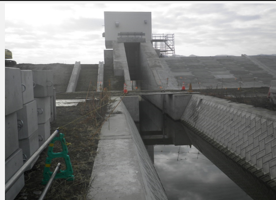
水門本体(陸側より撮影)
