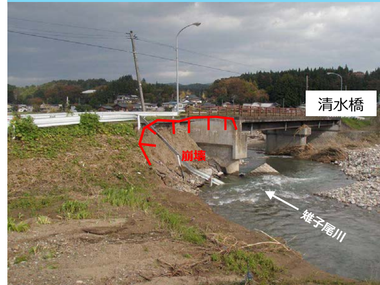
被害状況：雫子尾川
