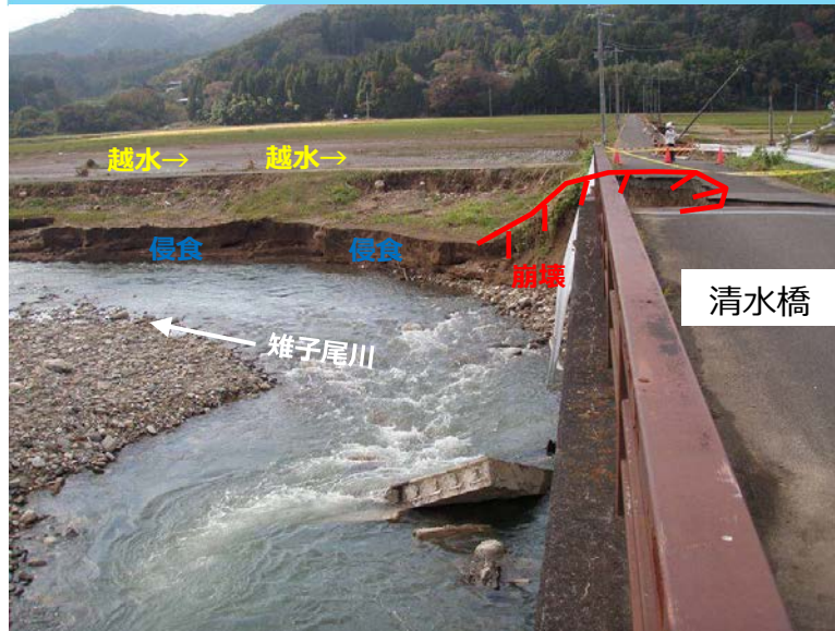
被害状況：雫子尾川
