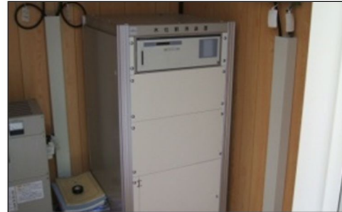
上大沢ダム テレメータ設備
